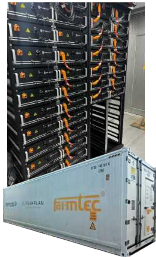
Bateriové úložiště v kontejneru.
