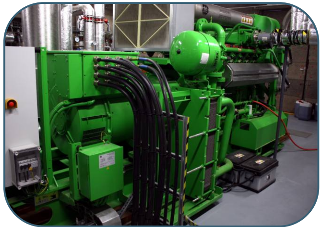
kogenerační jednotka GE Jenbacher
