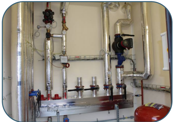
rozvodna tepla v kontejnerovém provedení
