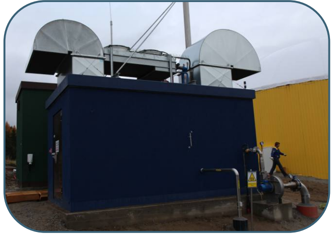
kontejnerové umístění kogenerační jednotky
