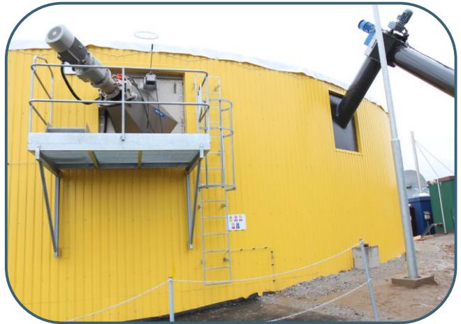
boční hřídelové míchadlo fermentoru
