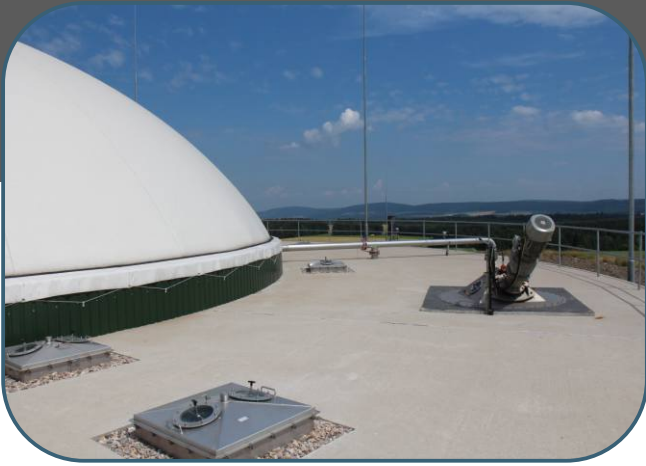
kontrolní poklpy s průhledítky
