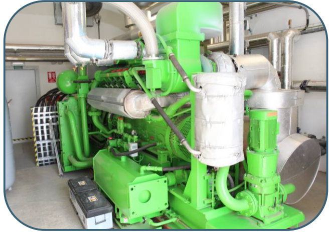
kogenerační jednotka GE Jenbacher
