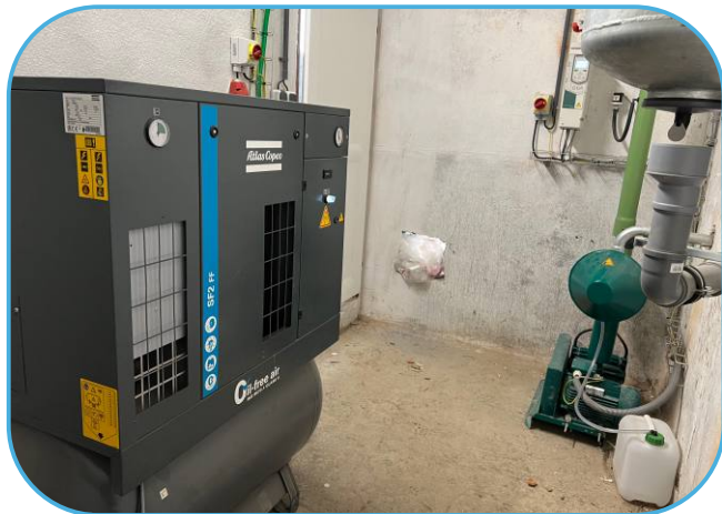
vlevo kompresor se sušičkou vzduchu, vpravo vývěva
