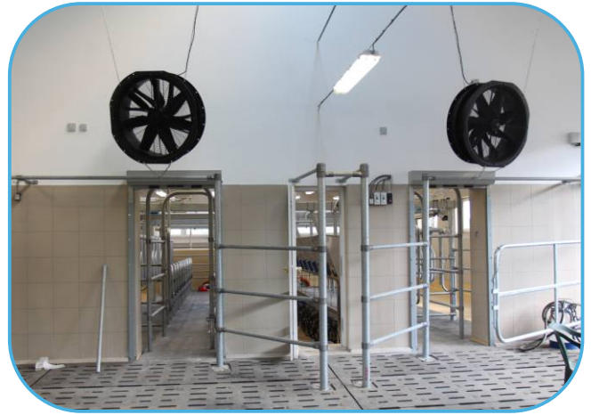
míchací ventilátory nad vstupem do dojírny
