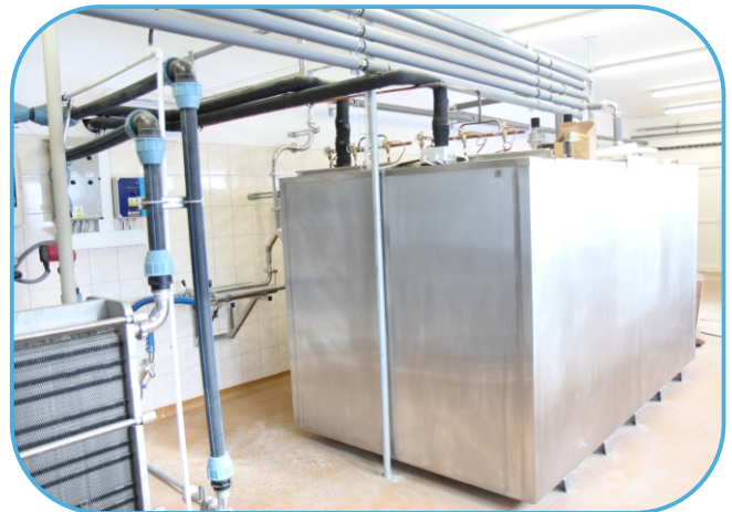
dvoustupňový předchladič s rekuperací
