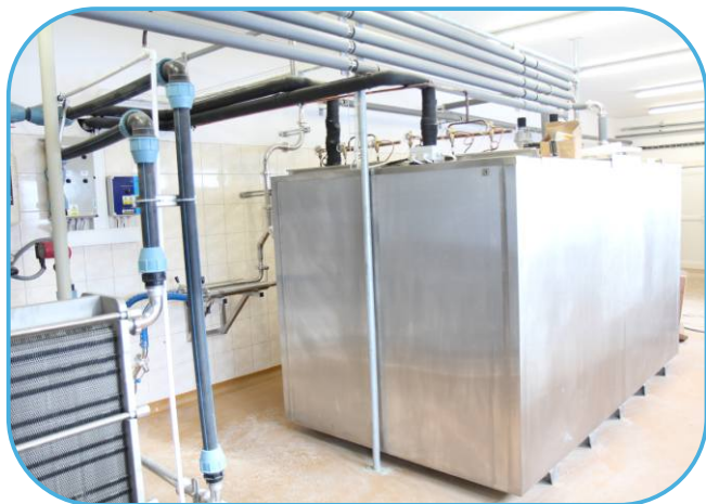
dvoustupňový předchladič s rekuperací
