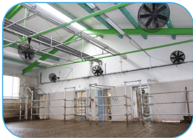
ventilátory v čekárně před dojením
