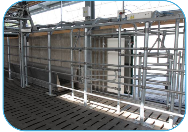
odchozí ulička s dezinfekční vanou
