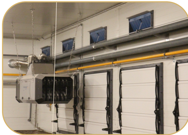
žebrové trubky teplovodního vytápění
