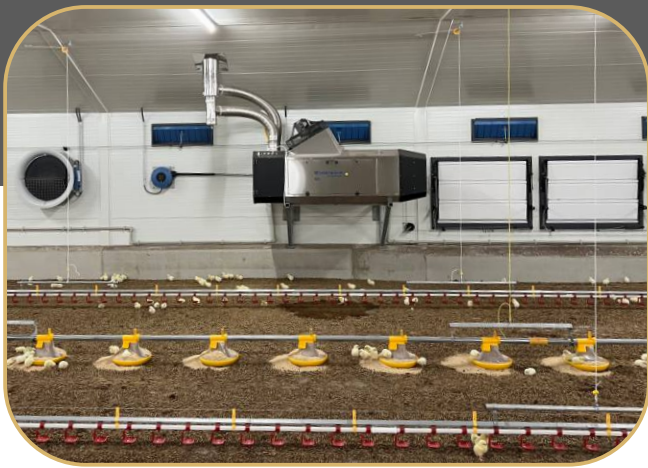
plynové topidlo DXC, stěnové přívodní klapky
