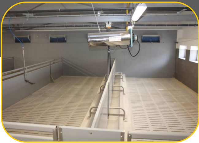
ve stáji jsou instalována plynová topidla
