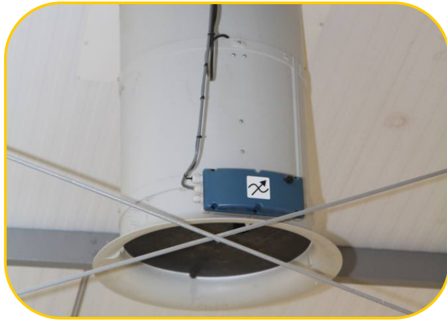
komín s odtahovým ventilátorem
