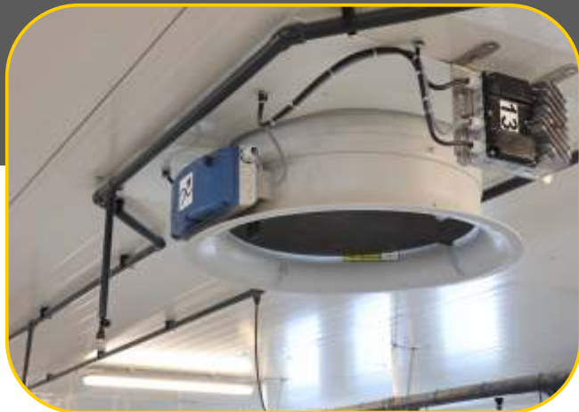
odvod vzduchu ve všech halách pomocí ventilátorů SKOV
