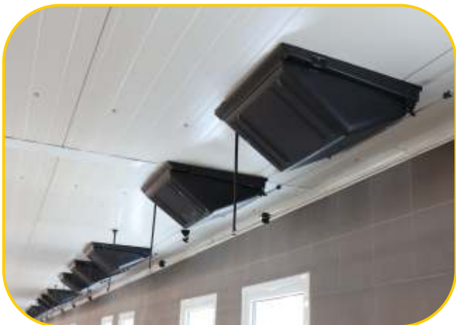
přívod vzduchu ve všech halách zajišťují stropní klapky
