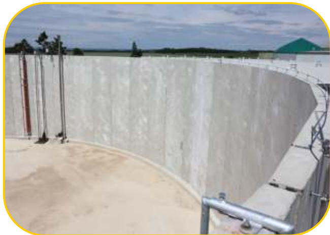
skladovací jímka na kejdu s čerpadlem a míchadly
