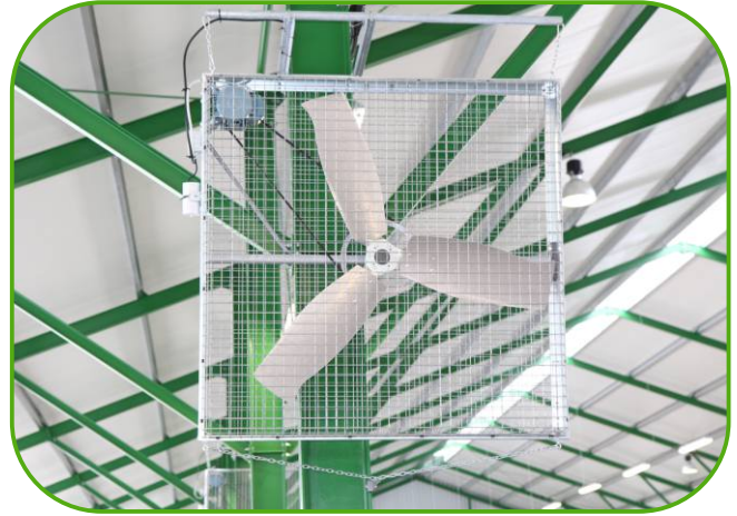
axiální ventilátory nad lehacími boxy
