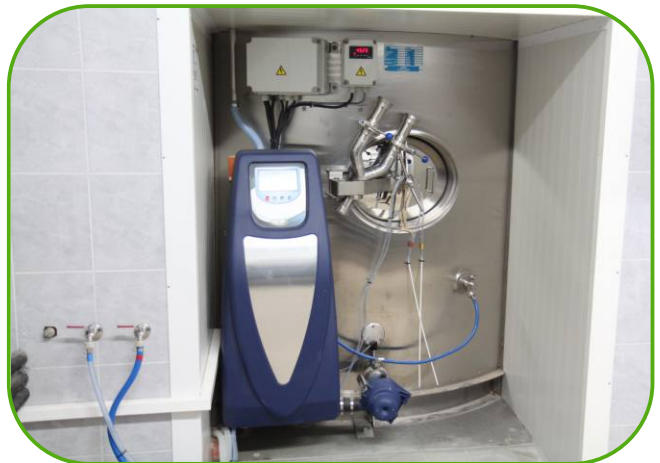
ovládací panel a pohled na silo z mléčnice
