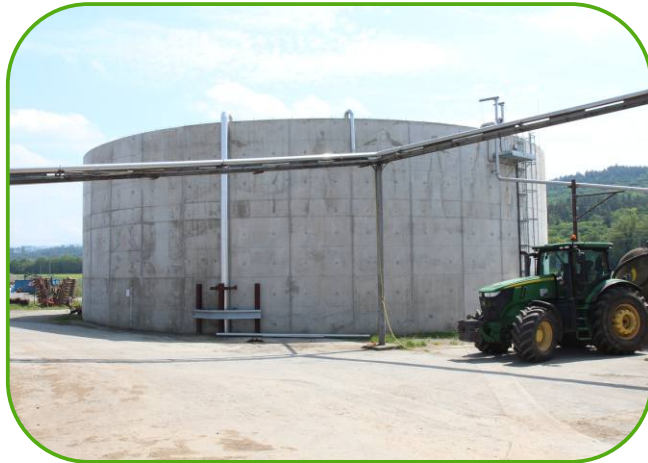
jímka na skladování kejdy s míchadly a čerpadly
