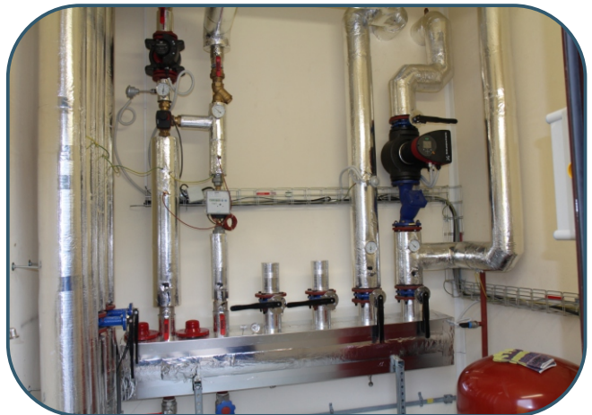
rozvodna tepla v kontejnerovém provedení
