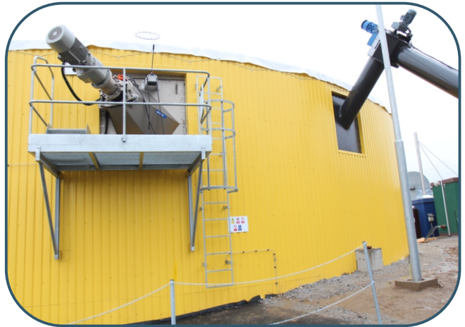
boční hřídelové míchadlo fermentoru
