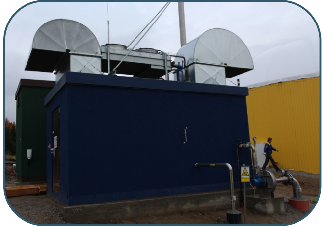
kontejnerové umístění kogenerační jednotky
