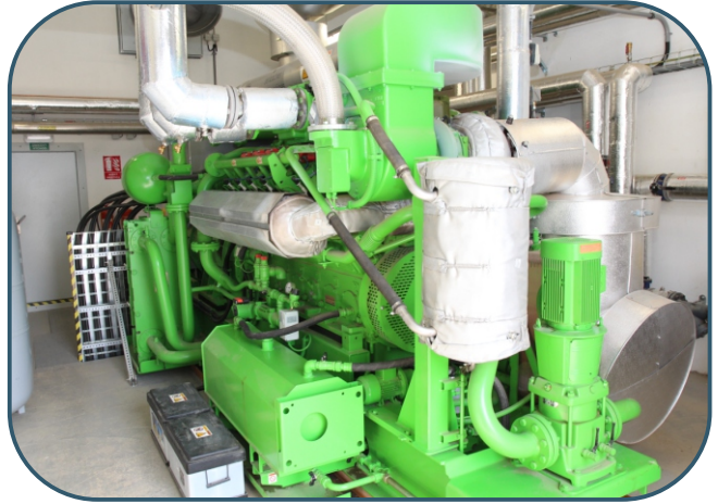
kogenerační jednotka GE Jenbacher
