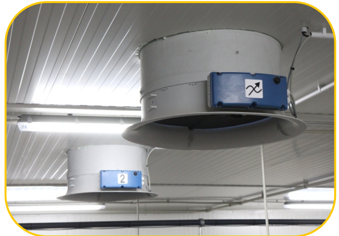
odtahové ventilační komíny
