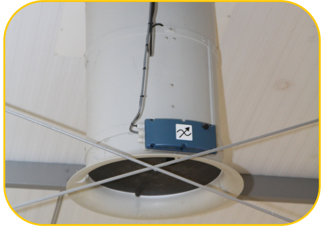
komín s odtahovým ventilátorem
