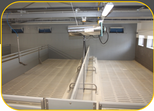
ve stáji jsou instalována plynová topidla
