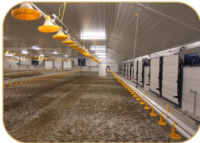
konec haly s tunelovými klapkami
