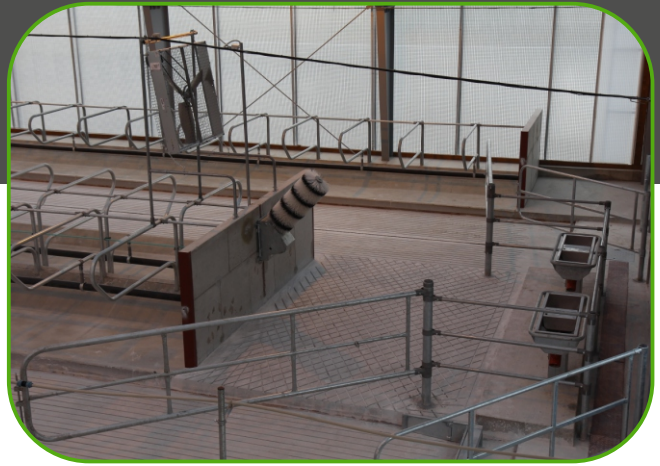
nerezové napájecí žlabky Neptun, drbadla a ventilátory
