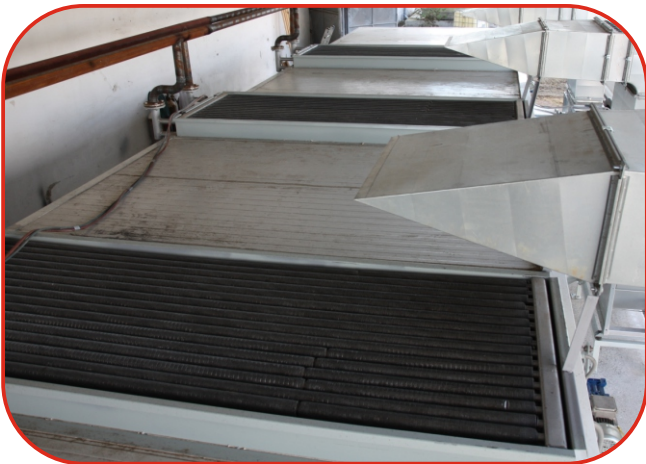
vstup čerstvého vzduchu do sušárny přes výměník
