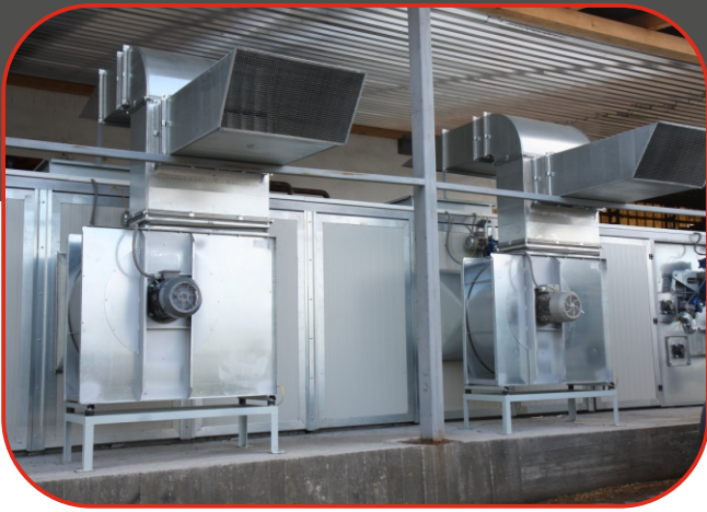
vzduchotechnická část - ventilátory
